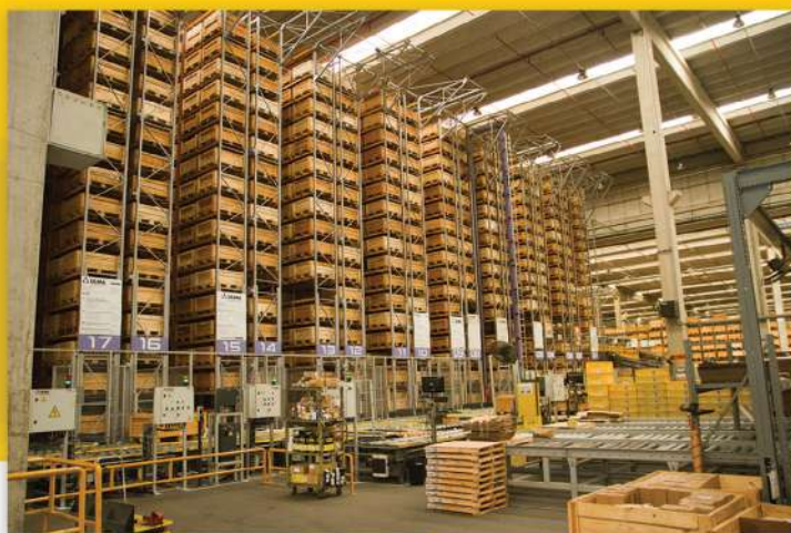
Transelevador (Centro de Distribuição Vinhedo/SP)
